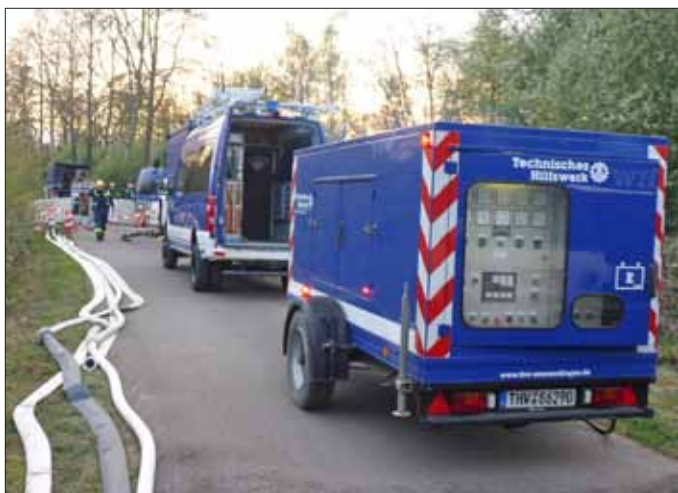
Neben der Option „mobile Werkstatt vor Ort“ hat man den Crafter als Zugfahrzeug für die Netzersatzanlage 80 kVA angeschafft.
